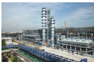
Газпромнефть-МНПЗ, г. Москва
